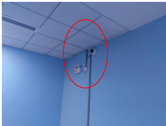
图4-7 本项目直线加速器机房迷道摄像头
