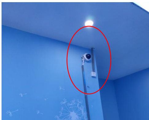
图4-9 本项目直线加速器机房东南侧摄像头
